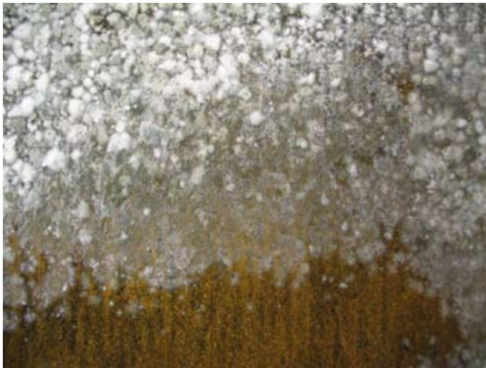
Bild 3: Optisch gut erkennbarer Schimmelpilzbefall eines Schalldämpfers.
