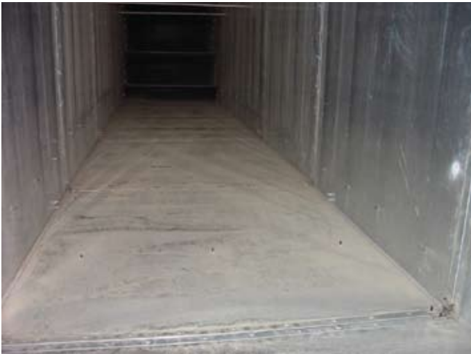
■ Bild 7: Optisch gut erkennbar: nicht besenreine Lüftungsleitung.
